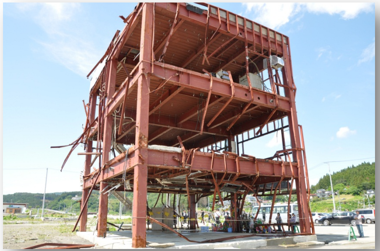
多くの町職員が亡くなられた防災対策庁舎
